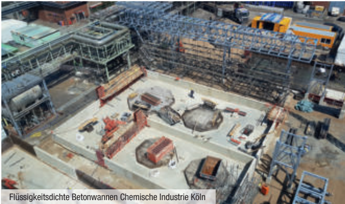
Flüssigkeitsdichte Betonwannen Chemische Industrie Köln
