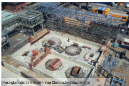
Flüssigkeitsdichte Betonwannen Chemische Industrie Köln
